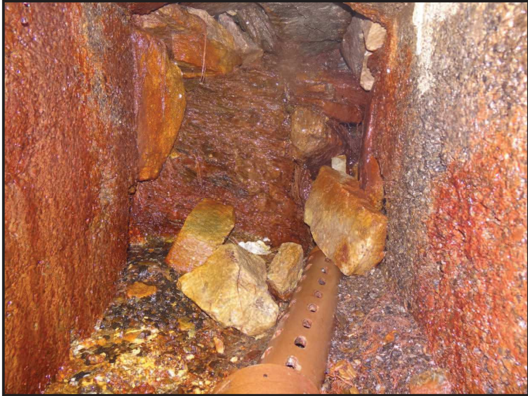
Obr. 2: podchycený pramenní vývěr v objektu HJ-4, prameniště Bátovka, foto R. Kalousek 2015
